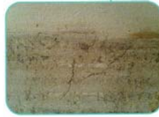
รอยแตกที่เกิดขึ้นบนผนังปูน
